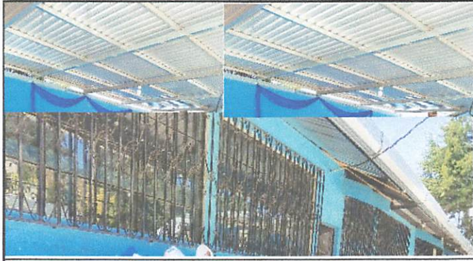
Necesario remozamiento de estructura metalica del techo y cambio de cubierta y cambio de canales
