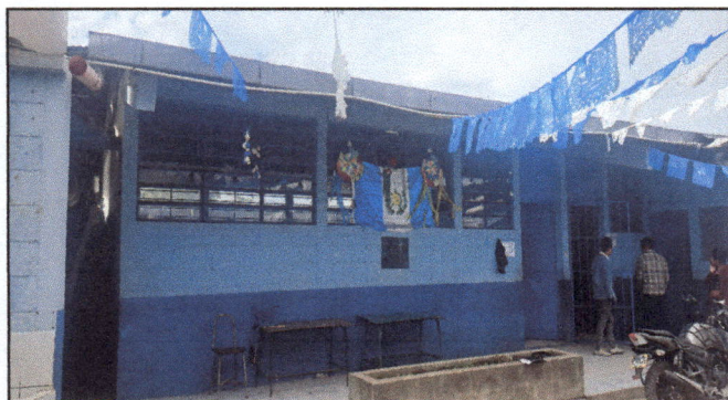
Foto 4: vista frontal de las aulas que se le colocarán balcones
