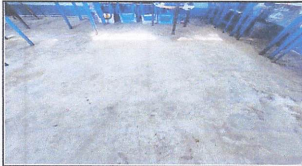
Foto 3: Piso de un salon totalmente en deteriorado.
