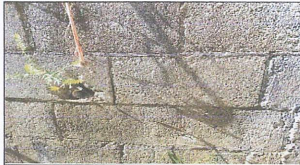
Foto 2: Los Blocks con agujeros, la mayoría en mal estado.
