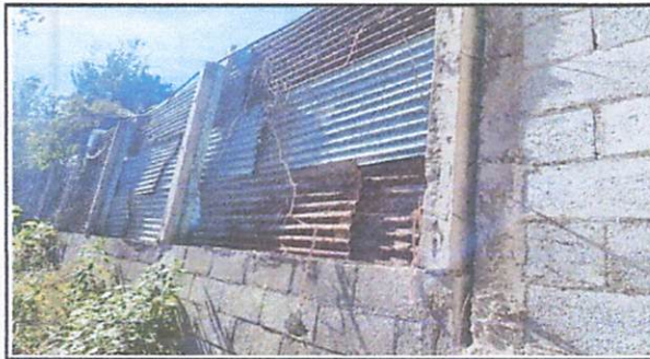
Foto 1: Muro perimetral con deterioro total.
