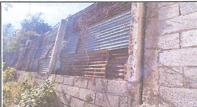
Foto1: Muro perimetral con deterioro total.
