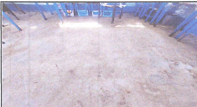
Foto 3: Piso de un salon totalmente en deteriorado.
