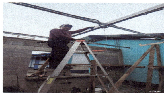
Foto 6: Instalación eléctrica de cocina de la EOUM 'Rafael Alvarez Ovalle'
