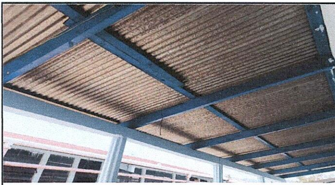
Foto 3: Sustitución de estructura de soporte de madera por metal y cambio de lámina por lámina troquelada aluzinc calibre 26
