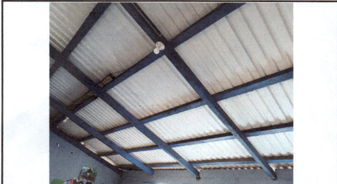
Foto1: Remiendos en la estructura de madera y aparición de termitas.
