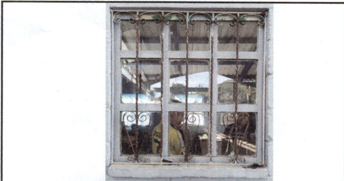
Foto 5: Deterioro de las ventanas y falta de ventilación.
