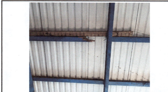
Foto 2: Quebradura de las vigas de madera y remiendos a la estructura.
