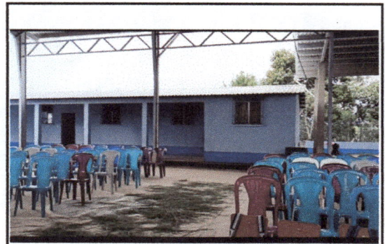
Foto 10: Falta de canales y salidas de agua.
