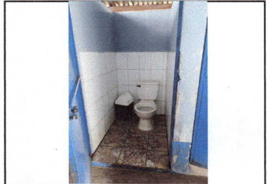
Foto 8: Deterioro de paredes por humedad.
