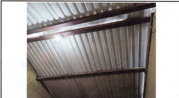
Foto 3: Deterioro y pudrición por la humedad.
