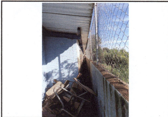
Foto 9: Deterioro de paredes y filtración de agua por falta de canales.
