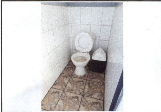
Foto 7: Deterioro de loza sanitaria.
