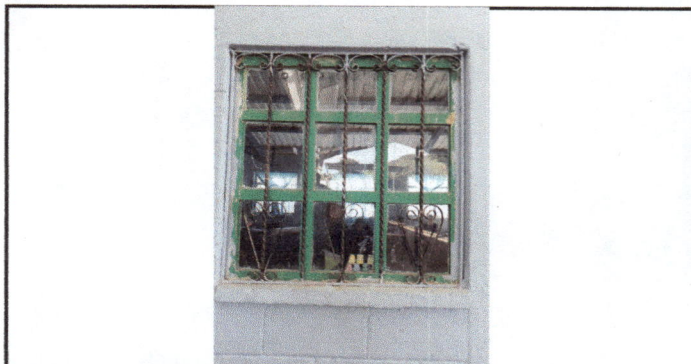
Foto 6: Deterioro de los balcones de metal.
