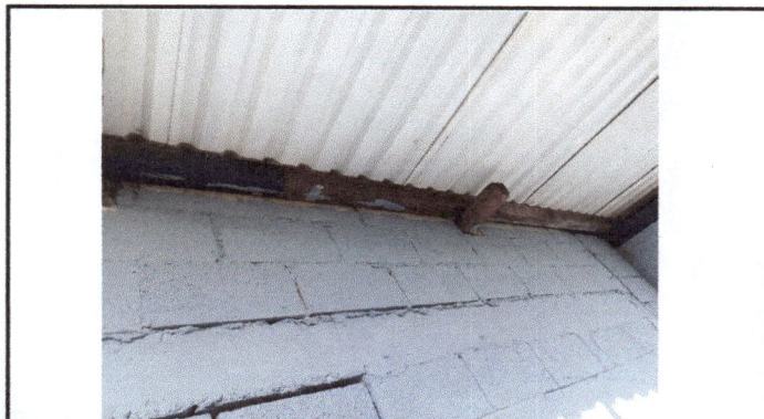
Foto 4: Falta de ventilación por la altura de las paredes.
