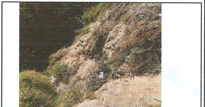
Foto 4: Deterioro del terreno debido a las aguas pluviales.
