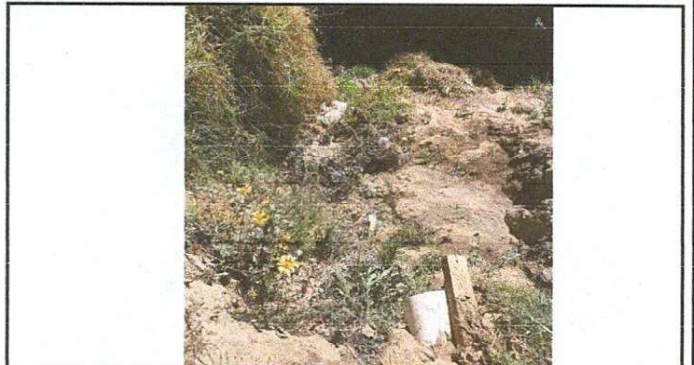
Foto 2: Erosión que ha causado el primer tubo principal de aguas pluviales.
