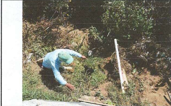
Foto 7: Tubo de aguas negras de la pila que por la posición en que se encuentra también causa erosión.
