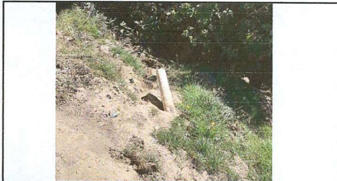
Foto 3: Segundo tubo principal de aguas pluviales que también causa erosión del terreno.
