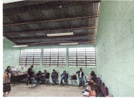
Foto 2: Aula de 6to. Grado sección A, para remozar sistema eléctrico, piso y cielo falso.
