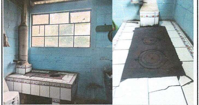
Foto 2: Remozamiento del pollo área donde se cocina la refacción, en esta área se necesita un cambio de plancha y azulejo ya que se encuentra deteriorado, cambio de tubo de chimenea.
