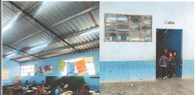
Foto 4: Remozamiento de la ventilación que se tiene en este salón es poco lo cual se solicita ventanas corredizas o algún otro tipo de ventana que ayude a la problemática, cambio de chapas en las puertas y pintar el aula.
