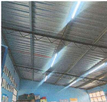
Foto 3: Remozamiento del techado del salón del grado de primero primaria, no se cuenta con un techado adecuado lo cual se solicita la mejora con cielo falso para contar con instalaciones de calidad.
