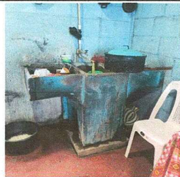
Foto 4: Remozamiento de la pila la cual se encuentra en mal estado y afecta en el lavado de los utensilios de cocina.
