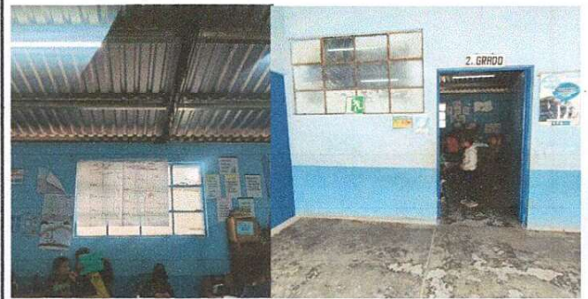
Foto 2: emozamiento de la ventilación que se tiene en este salón es poco lo cual se solicita ventanas corredizas o algún otro tipo de ventana que ayude a la problemática, cambio de chapas en las puertas y pintar el aula.
