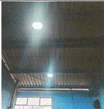
Foto 3: Remozamiento del techo e iluminación del área de cocina, en este espacio se cuenta con poca iluminación la cual dificulta para cocinar por ello se solicita mejorar la iluminación y el techado con la colocación de cielo falso, para tener mejores condiciones a la hora de preparar la refacción escolar.
