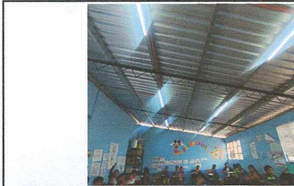
Foto1: Remozamiento del techado en el salón del grado de segundo primaria, no se cuenta con un techado adecuado lo cual se solicita la mejora con cielo falso para contar con instalaciones de calidad.
