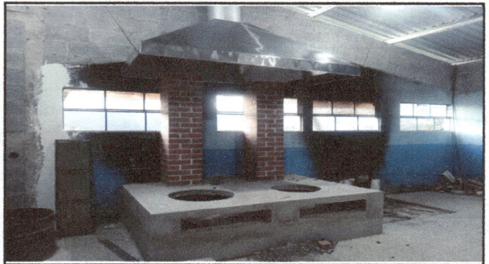
Foto 2: terminacion de polletones y chimenea de acero inoxidable
