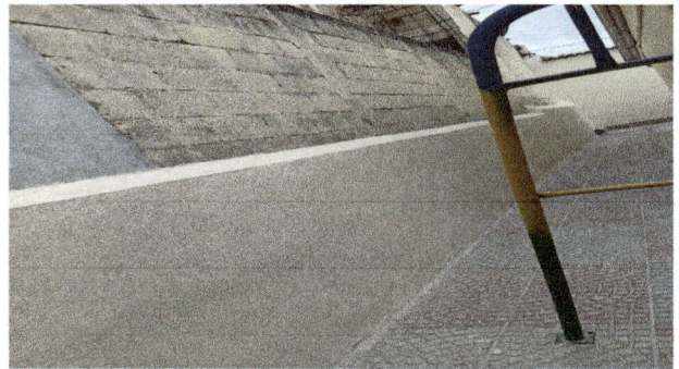
Foto 2: filtraión, piso en patio
