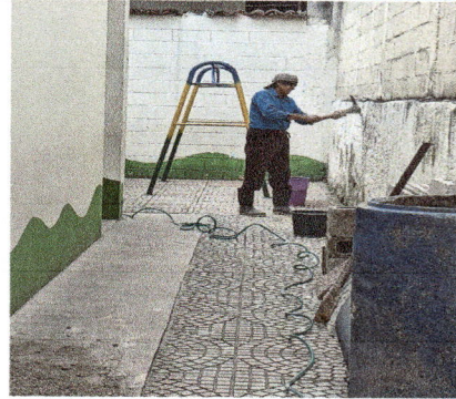
Foto 2: filtración, piso en patio
