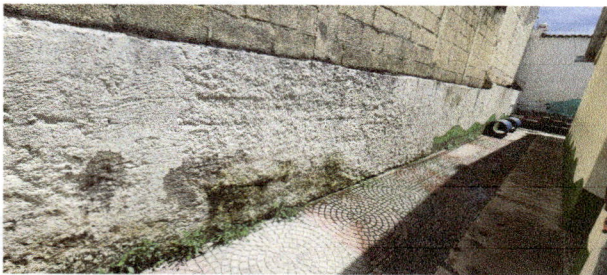
Foto 3: filtración, piso en patio, cisterna
