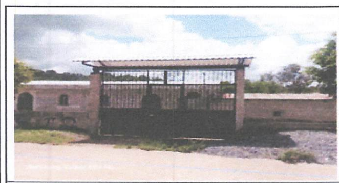
Foto 5: Sustrucción de porton de metal
