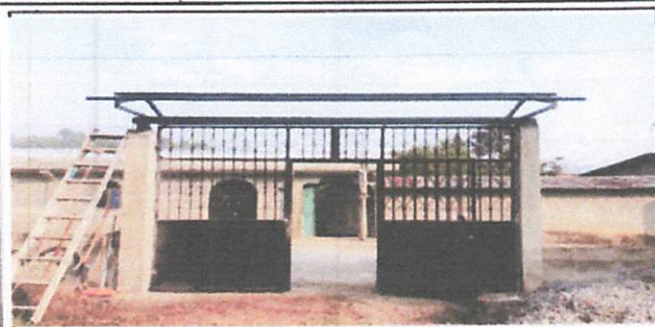
Foto 1: Sustrucción de estructura de soporte de madera por metal, se realizo un cambio por la sombra del porton principal. Consta acta No. 16-2024
