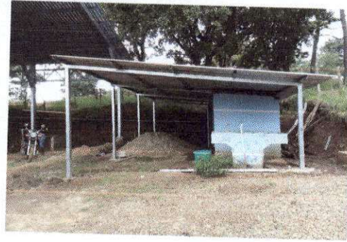
Foto 2: Cubierta de lamina de sanitario.
