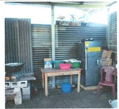
Foto 6. Pared de lámina, sustituir por pared de block
