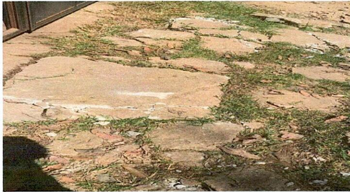
Foto 1: losa de concreto en mal estado
