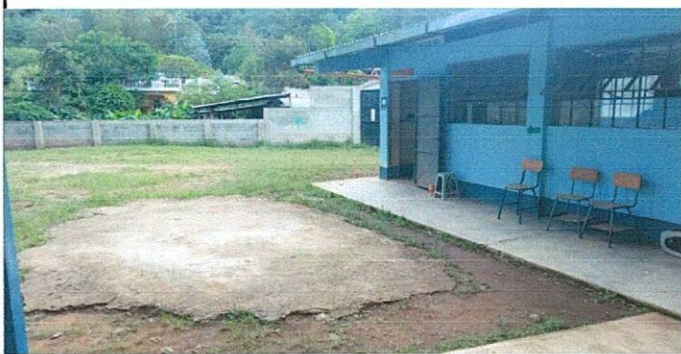
Foto 3: patio en mal estado
