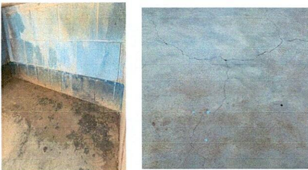
Foto 9: paredes con humedad y piso en mal estado en los sanitarios
