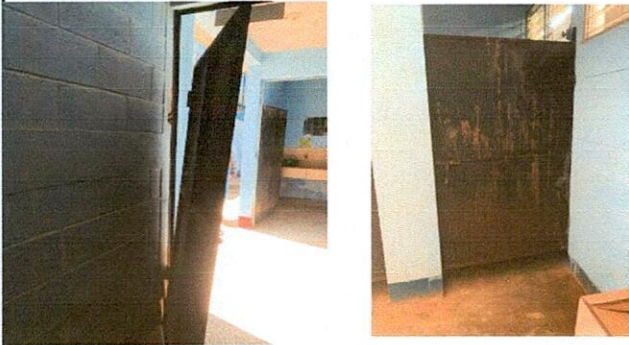
foto 7: puertas de los sanitarios en mal estado
