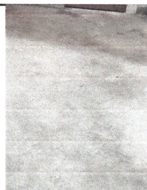
Foto 6: Piso torta de cocina deteriorado
