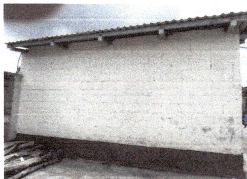
Foto 2: Pared de cocina deteriorada
