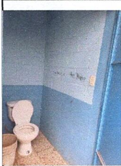
Foto 3: Tubería de los sanitarios en mal estado.
