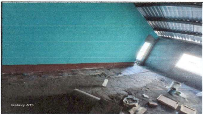
Foto 3: PISO DE COCINA
