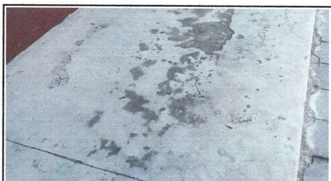
Foto 4: PISO DE AULAS
