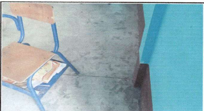
Foto 3: PISO DE AULAS
