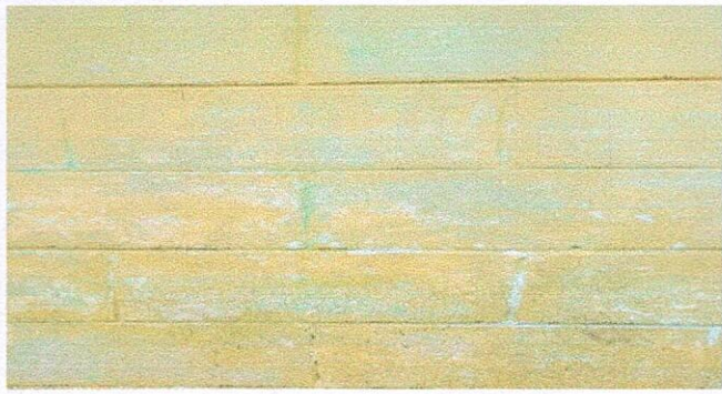
Foto 1: Pintura; se necesita mantenimiento de pintura en paredes de salones y corredores
