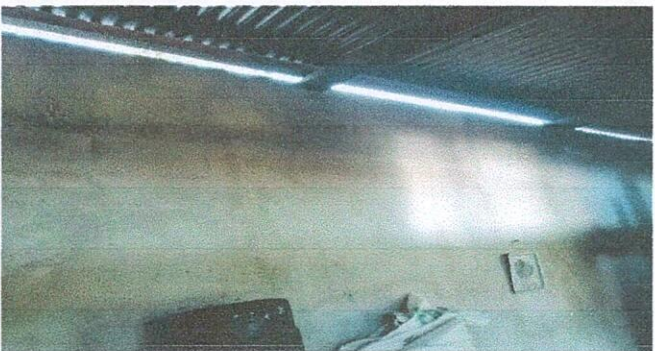
Foto 3: Se necesita mantenimiento de paredes de la cocina ya que se encuentran en mal estado, por lo cual se repellará.
