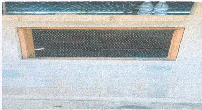
Foto 3: Ventana inadecuada para la cocina, se hará el cambio a una de metal.
