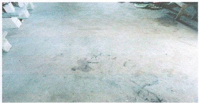
Foto 1: En la cocina se tiene torta de concreto por lo que se propone la instalación de piso cerámico para una mejor higiene.
