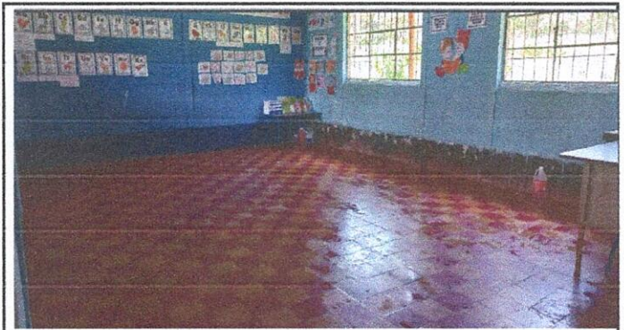
Foto 4: Sustitución de piso ladrillo de color por cerámica del aula de primer grado
