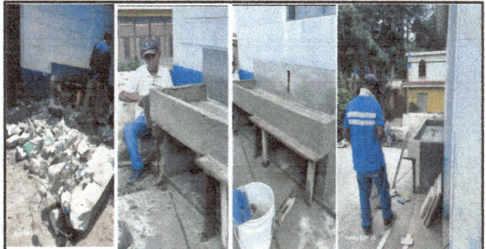
Foto 6: filtracion de agua en cocina, por lavamanos
