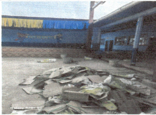
Foto 3: piso en corredor
