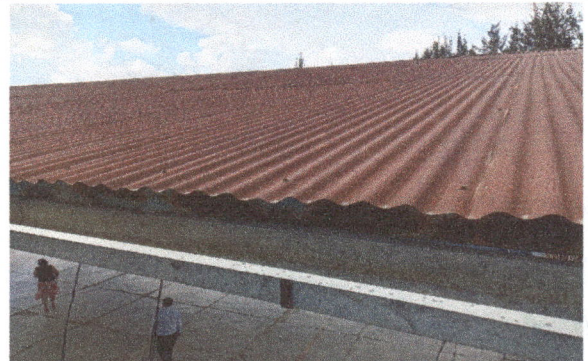
Foto 2: Lámina totalmente quemada y oxidada que se cambiará
