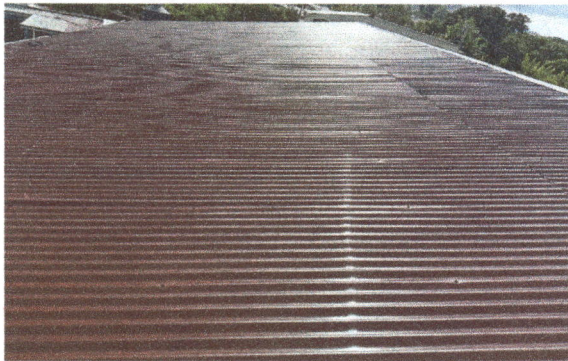
Foto 3: Techo de dos alas completamente oxidadas,
