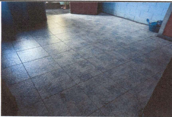
Foto 3: Piso en cocina
