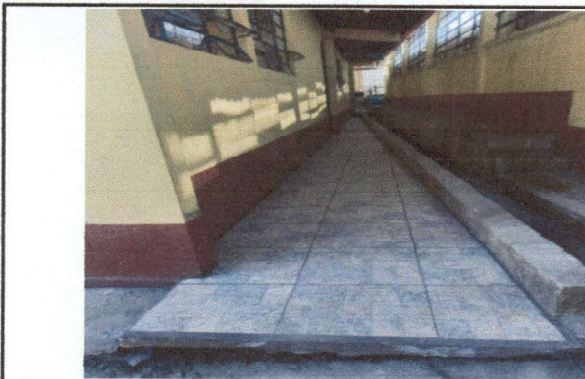
Foto 9: Piso pasillo 2 planta baja
