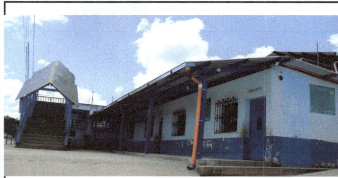
Foto1: Modulo 2 Cambio de techado completo de 2 salones que se encuentra en la entrada del lado izquierdo de la escuela, cambio de parales y colocación de lineales de canales enfrente y atrás de los salones.
