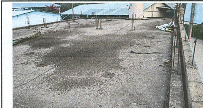
Tomada en la parte de arriba de la terraza de la dirección, donde hay filtración de agua
