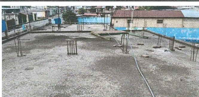
Tomada en la parte de arriba de la terraza de los tres salones en donde ocurre filtración de agua
