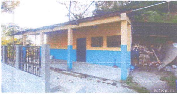
Foto 1: La cocina actualmente no tiene suficiente ventilación, el piso es de concreto, el techo está en mal estado
