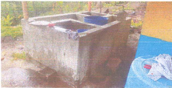
Foto 3: Nuestra pila es demasiado pequeña, y esta deteriorada.
