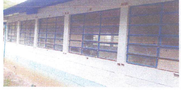
Foto 2: Es necesario instalar balcones a las ventanas para mayor seguridad.
