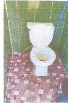
Foto 4: El Sanitario se encuentra en mal estado
