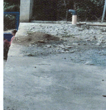
Foto 2: Romper torta e instalación de tubería salida de agua en la entrada de la escuela.
