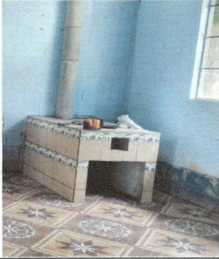
Foto 1: Construcción de pollo chimenea de tubo concreto de 4 medidas 140 largo x 90 ancho x 85 alto con plancha y azulejo
