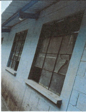
Foto 1: Corredizos 80x80 ventanales existentes.
