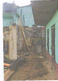
Foto 2: Aquí se levantaron las paredes para poner al mismo nivel de la parte superior del terreno.
