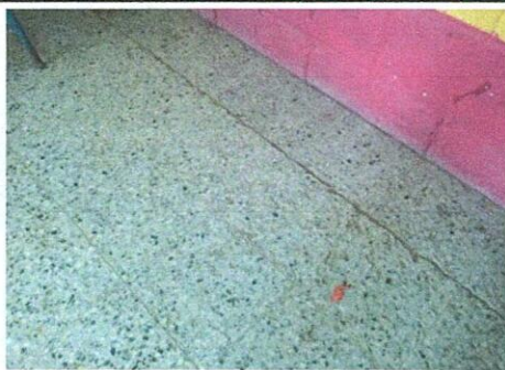
FOTO 3: sustituir 112 mts.2 de piso a ceramica, ya que este esta en malas condiciones.
