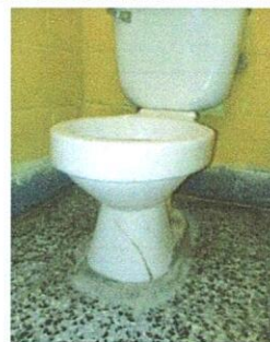
FOTO 4: cambiar 6 sanitarios con sus accesorios, pues los actuales estan en malas condiciones, con su lavamanos de cemento.
