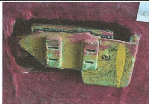
FOTO 4: Sustrucción de tomacorriente
