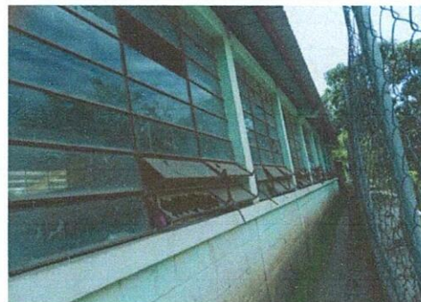
FOTO 2: Cambiar los vidrios que estan quebrados y darle el mantenimiento a las ventanas pintando la estructura.
