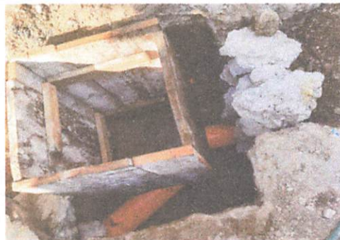
Foto 8: Drenaje de aguas negras
