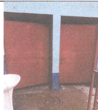
Foto 12: Puertas de metal sanitarios No. 1
