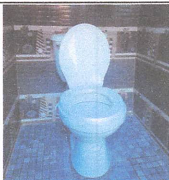
Foto 11: Inodoro a cambiar en sanitarios No. 1
