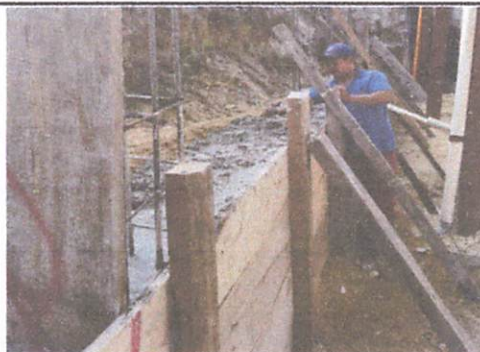
Foto 10: Área con necesidad de muro de contención
