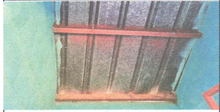
Foto 6: Estructura de metal de sanitarios No. 1
