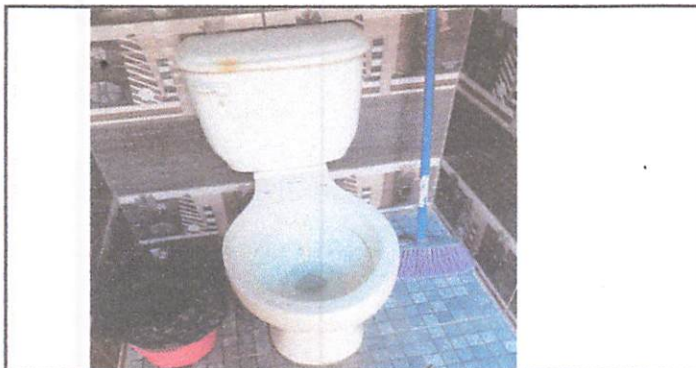
Foto 11: Inodoro a cambiar en sanitarios No. 1
