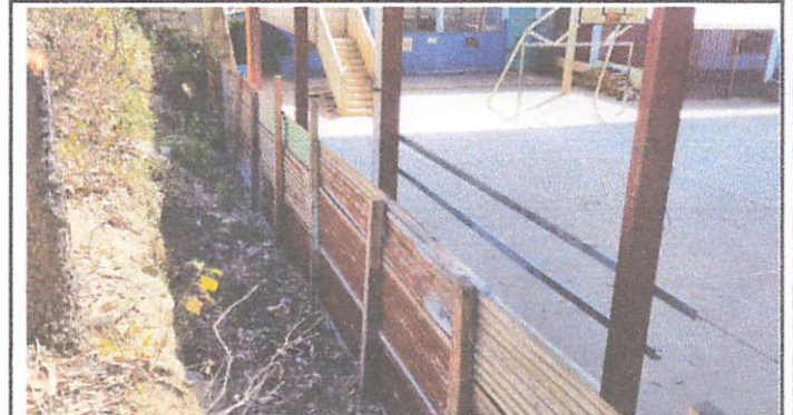
Foto 10: Área con necesidad de muro de contención
