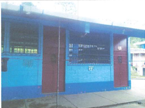
Foto 3: La baranda del establecimiento estaba en muy mal estado.
