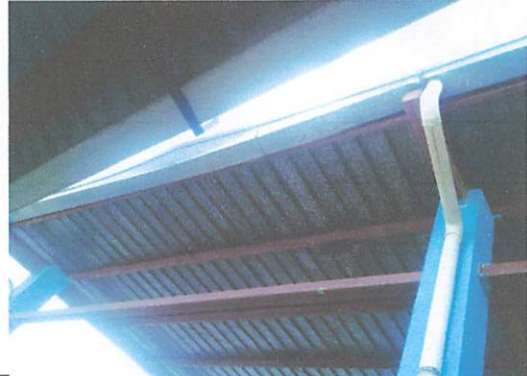
Foto 4: Canales en mal estado.
