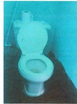
tubería, deposito de agua y sanitarios en mal estado.
