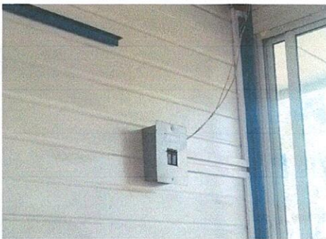
cambio de caja de flipones en modulo
