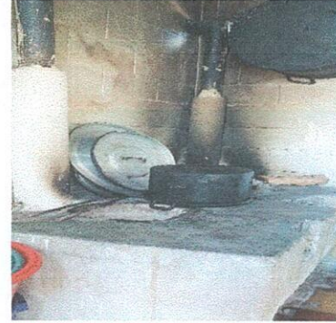
Foto 2: El pollo es una construcción improvisada por padres de familia, no cuenta con una chimenea funcional.
