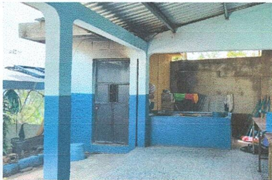
Foto 3: La cocina está ubicada en un espacio en el que no es funcional hacer remozamiento debido a que se necesitan hacer cambios estructurales en el corredor y un salón de clases.
