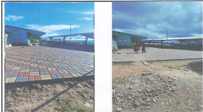
Foto 3: SUSTITUCION DE PATIO EN ADOQUINADO E INSTALACION DE DRENAJE DE AGUA PLUVIAL.
