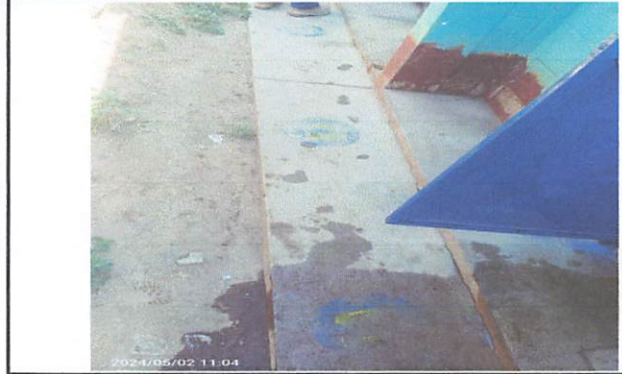
Foto 2: PASILLO ANGOSTO, AMPLIAR PASILLO PARA UNA BUENA CIRCULACION DE LOS NIÑOS EN CUANTO AL USO DEL SERVICIO SANITARIO.
