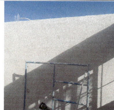
Foto 4: PAREDES DE COCINA SIN ACABADO, SE NECESITA UN ACABADO DE CERNIDO HACIA LAS PAREDES DE COCINA + PINTURA BASE AGUA
