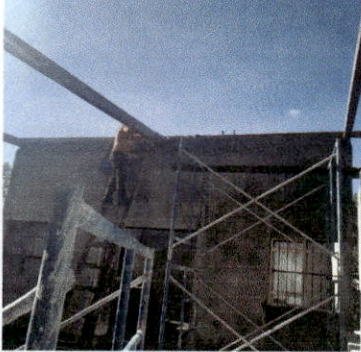
Foto 1: CAMBIO DE ESTRUCTURA DE MADERA POR ESTRUCTURA DE METAL + CAMBIO DE LAMINA POR LAMINA TROQUELADA CALIBRE 26 ALUZINC.
