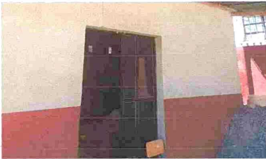
Foto 3: SE NECESITA MANTENIMIENTO EN PUERTA, CAMBIO DE CHAPA Y PINTADA,
