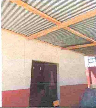
Foto 1: SE NECESITA CAMBIAR ESTRUCTURA PORTANTE DE METAL Y CHADO DE LAMINA
