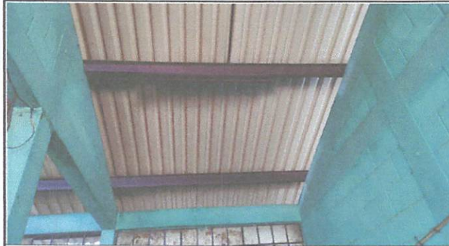
Foto 1: ES NECESARIO EL MANTENIMIENTO DE ESTRUCTURA DE TECHO EN COCINA.
