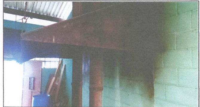
Foto 2: PAREDES CON NESESIDAD ACABADO DE CERNIDO..
