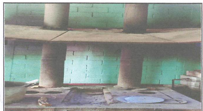
Foto 4: ESTUFAS RURALES DETERIORADAS, ES NECESARIO LA SUSTITUCION DE ESTAS DOS ESTUFAS.
