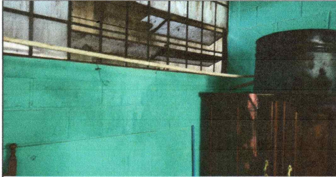
FOTO 7: VENTANAS EN MAL ESTADO Y DETERIORADO, SE NECESITA CAMBIO DE VENTANAS EN COCINA.
