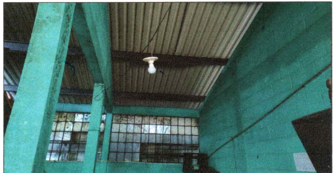
Foto 6: ILUMINACION EN MAL ESTADO, ES NECESARIO NUEVA INSTALACION.
