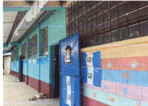
Foto 4: MODULO #1: PINTURA DETERIORADO, ES NECESARIO LA APLICACION DE PINTURA DE AGUA + ZOCALO DE PINTURA ACEITE.
