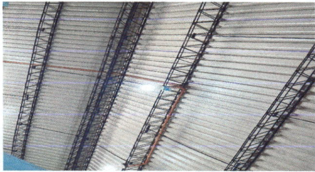
Foto 1: MODULO #1: AULAS SIN ILUMINACION, ES NECESARIO NUEVA INSTALACION USANDO PLAFON Y BOMBILLAS LED.
