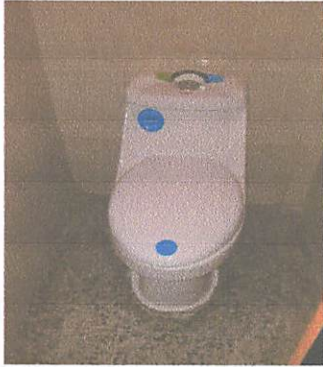
Foto 1: finalizacion de colocacion de sanitarios push e instalacion de tubería para agua potable.
