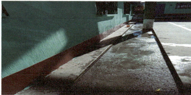
Foto 5: CUNETA SIN PAMIMENTO
