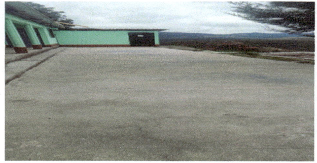
Foto 2: PATIO MAL ESTADO
