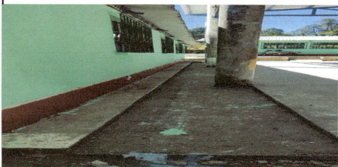
Foto 5: CUNETAS SIN PAVIMENTO
