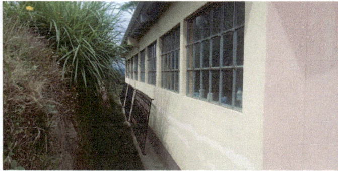
Foto1: AULAS SIN BALCONES
