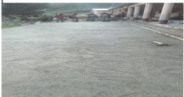
Foto 2: PATIO MAL ESTADO
