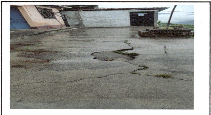
Foto 2: PATIO MAL ESTADO
