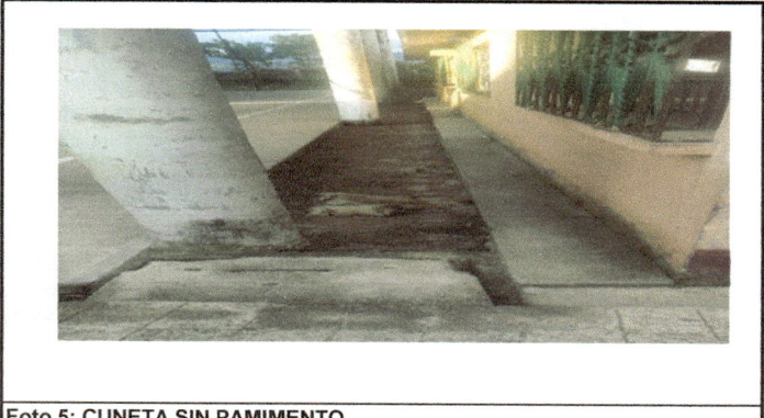
Foto 5: CUNETAS SIN PAVIMENTO
